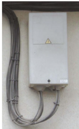
Figura 8.7. Caja general de protección de una acometida aérea.
