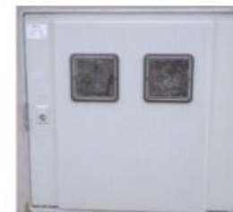
Figura 8.2. Caja de protección y medida (CPM).
