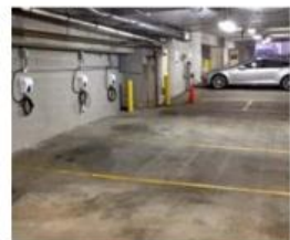
Figura 8.3. Estaciones de recarga de vehículos en garaje.
