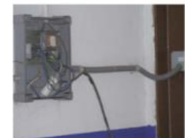
Figura 8.26. Cuadro de control de puerta de garaje.
