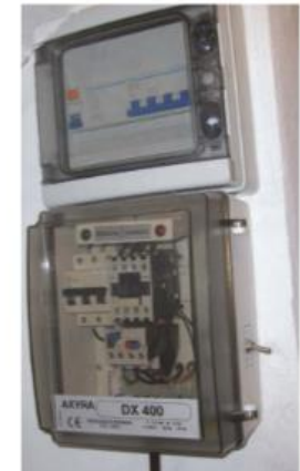
Figura 8.25. Cuadro de mando y protección de una bomba de elevación de aguas.
