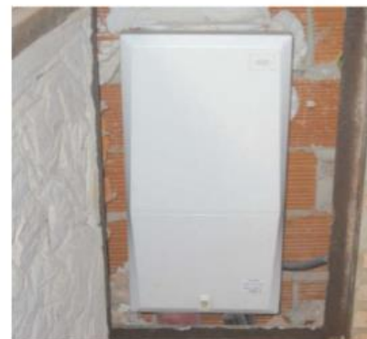
Figura 8.4. CGP alojada en nicho para una acometida subterránea con puerta revisada exteriormente con las características de la fachada.
