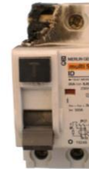
Figura 12.13. Diferencial quemado por falta de protección.
